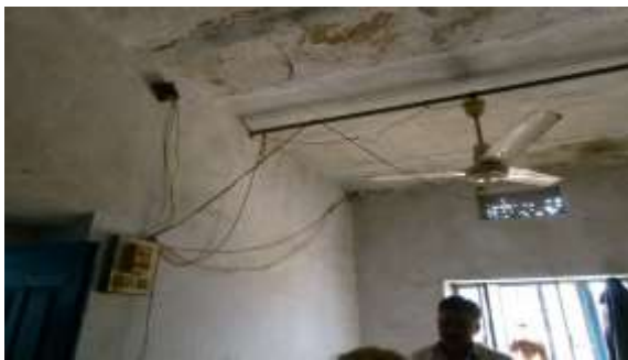
Le vieux dispensaire : état des installations électriques
